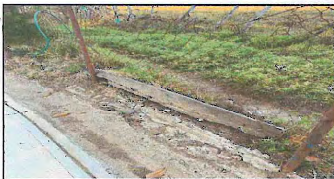
Foto 5: Los tubos se encuentran quebrados y otros estan doblados
