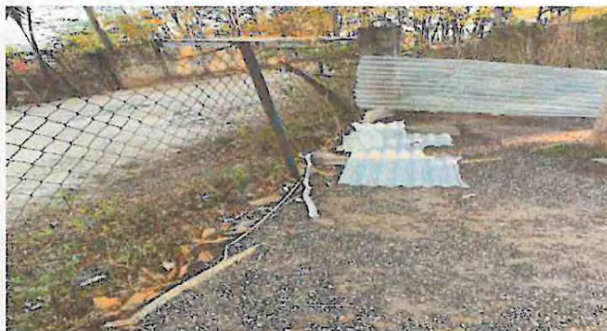
Foto 4: La malla se encuentra baja y dañada
