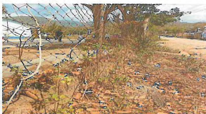
Foto 2: malla toda oxidada y floja
