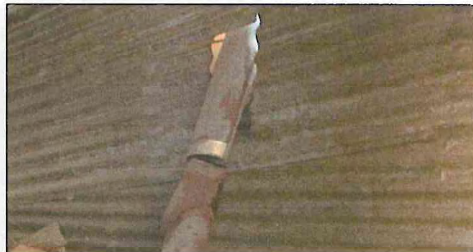
Foto 4: chimenea mal pegada y mal colocada.
